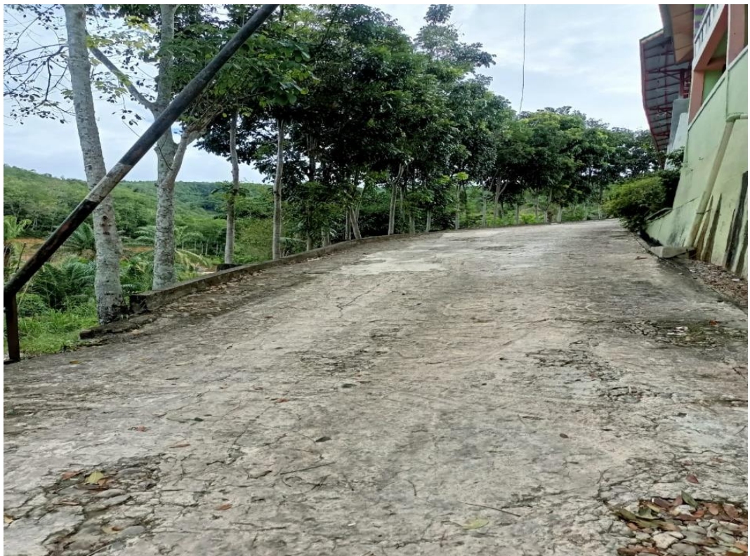
Kondisi jalan masuk ke area wisata
