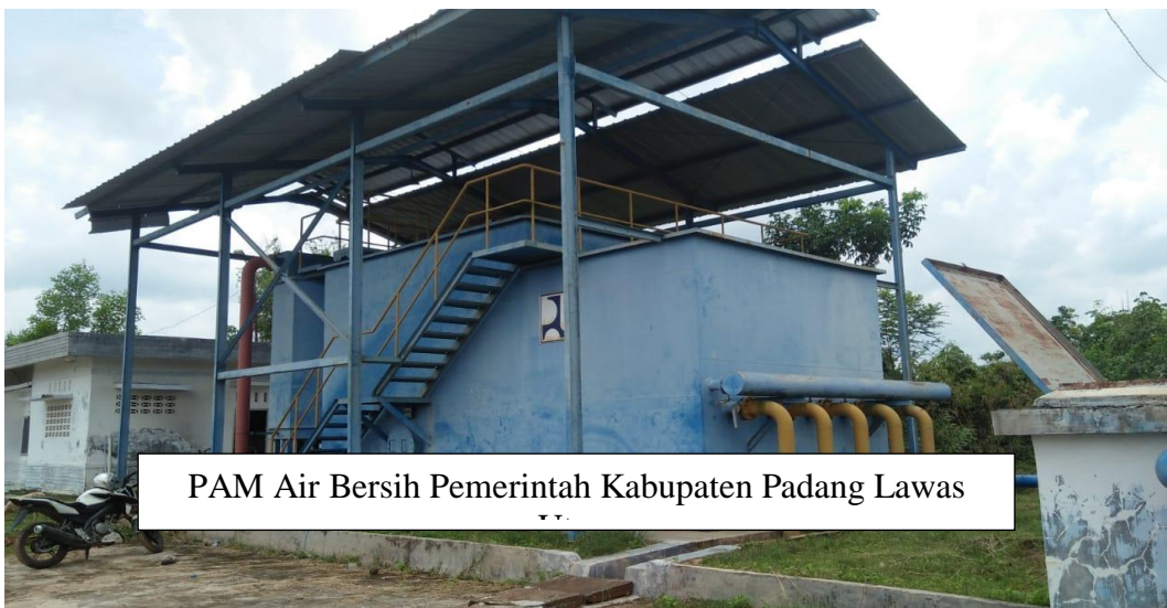
Mesin Air PAM Air Bersih Masjid
