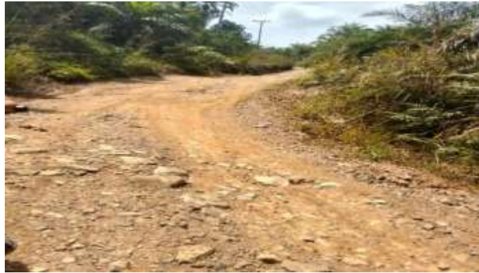
Gambar. IV. 1 Data kondisi jalan Desa
